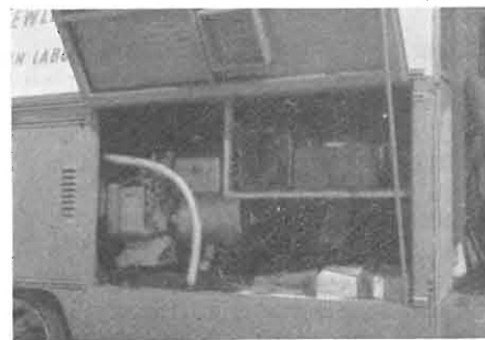
Fig. 5 - Il furgone attrezzato è munito di un gruppo elettrogeno, visibile nella fotografia, destinato ad assicurare il funzionamento delle apparecchiature in ogni località.
